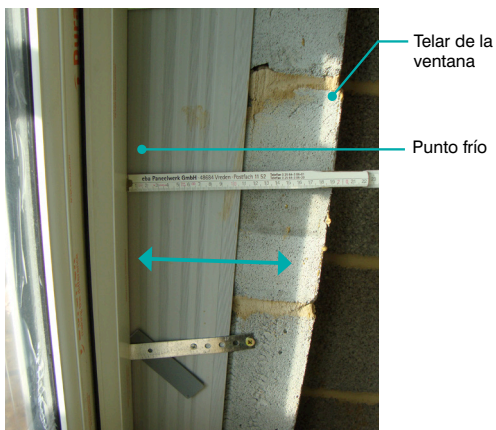
Figura 0.1 El marco no se superpone al hueco de la cámara y crea un puente térmico.
